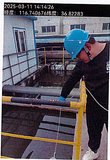
三期酚氰废水处理站清水池
