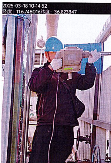
2#燃气轮机组排气筒 (DA002)
